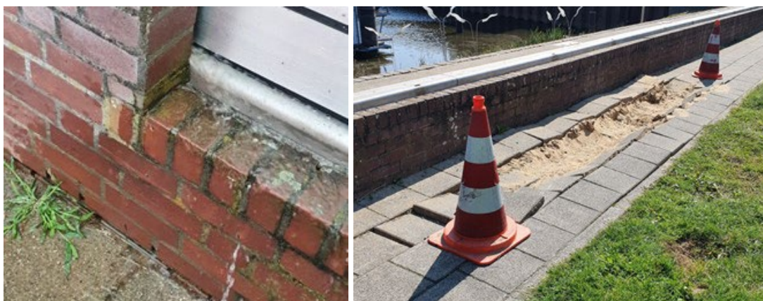
Figuur 9.10 Uittredend water door de demontabele kering bij locatie (1) tijdens hoogwater (links) en omgewoelde zandlaag binnendijks na afloop van het hoogwater (rechts)
