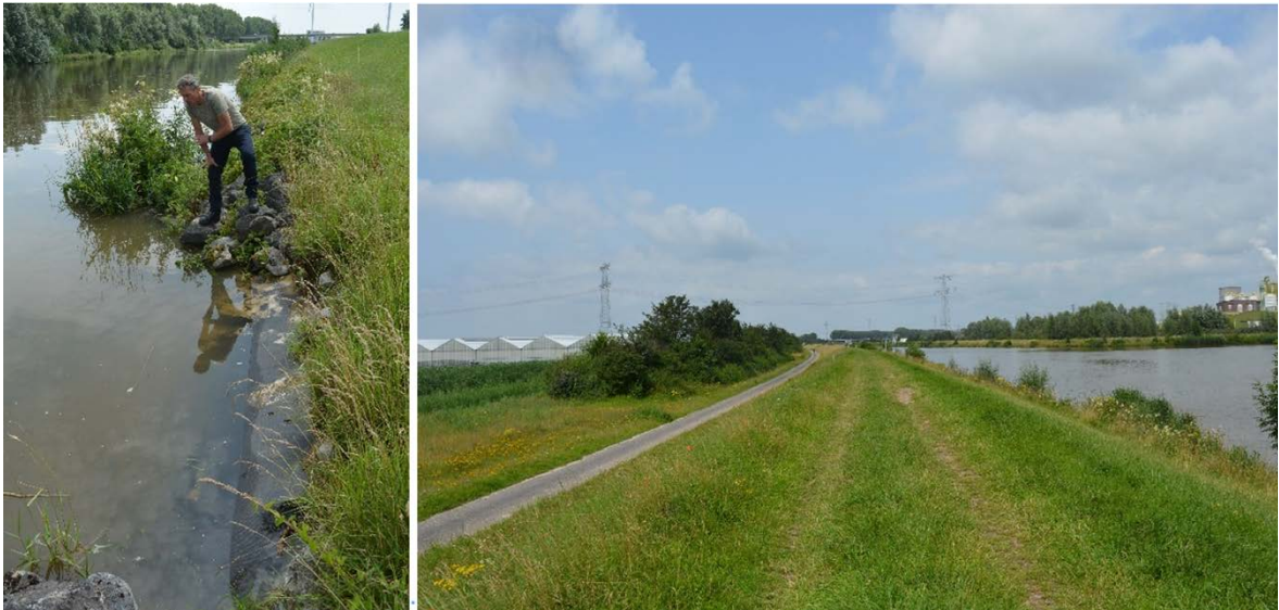
Figuur C.7.1: Buitentalud met deels ontbrekende steenbestorting rond de waterlijn, dijk met binnendijks achtereenvolgens een weg, een smalle diepe sloot, een goederenspoorlijn en een groot kassengebied.
