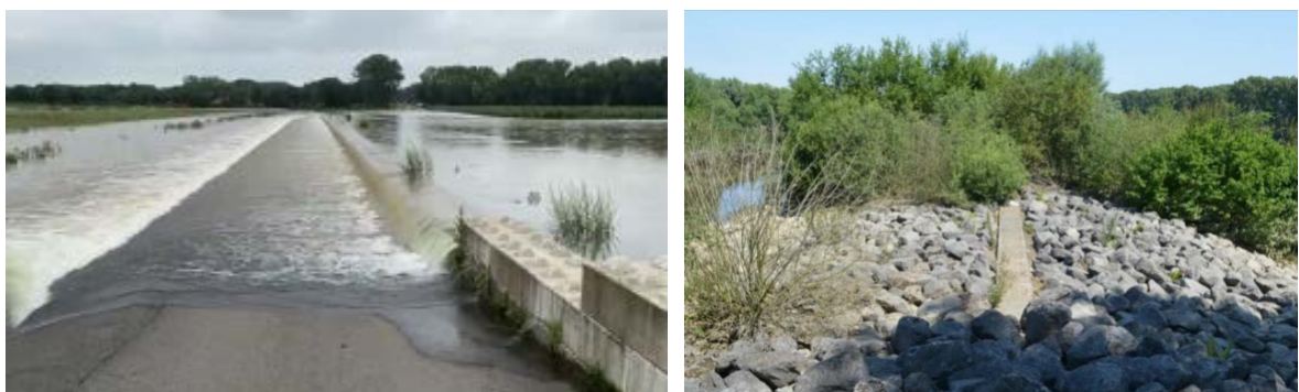
Figuur B.1.6.1: Inlaatdrempels van retentiegebied LKW. Links de inlaat van het zuidelijk bekken tijdens het hoogwater, gezien vanuit het zuidwesten. 20 Rechts de inlaat van het noordelijk bekken na het hoogwater, gezien vanuit het noorden.
