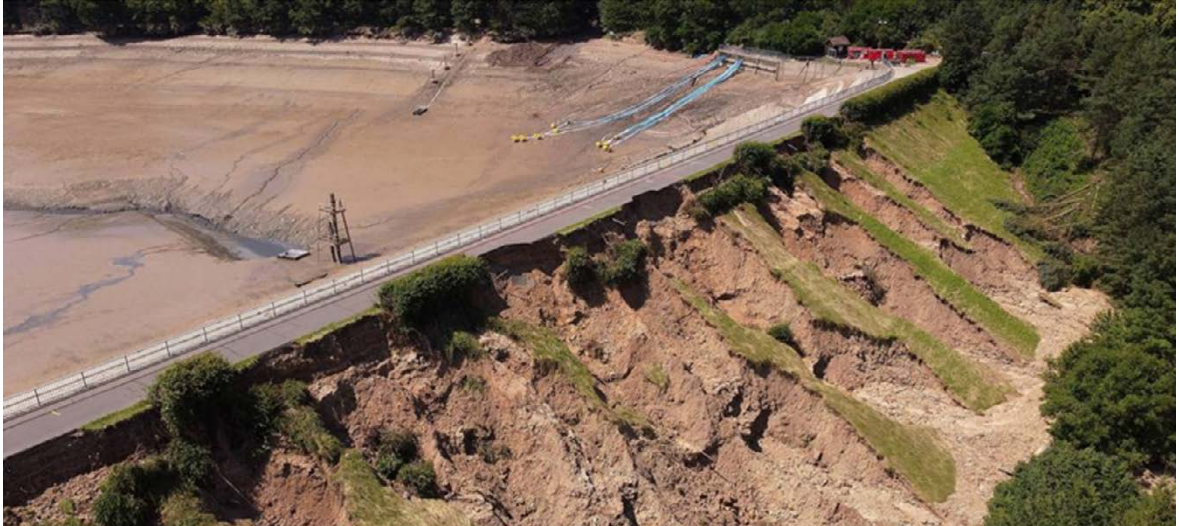
Figuur 8.4: Lege dam bij Steinbach met zichtbare overstromingsschade. (General Anzeiger, 2021. Foto: dpa/David Young)
